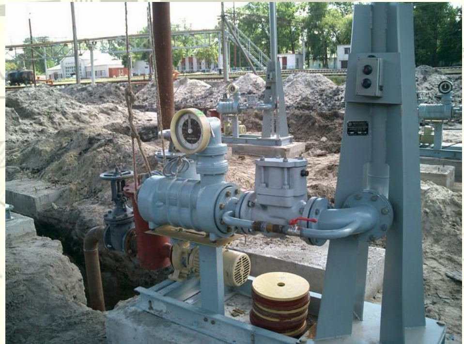
Узлы выдачи на основе отечественного оборудования
